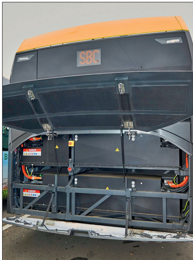
Vier der sechs Batterien sitzen im Heck. Der Urbino Electric kann auch mit weniger Kapazität und Zwischenladungssystemen geliefert werden
